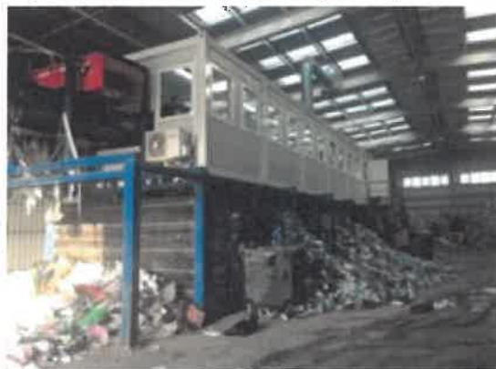
Figura 18: Stație de sortare Bacău
